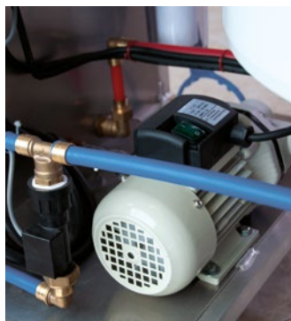
Débitmètre d'eau pour le démarrage automatique de la pompe de vidange.
