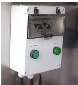
Interrupteur marche forcée pour la vidange des bacs.
